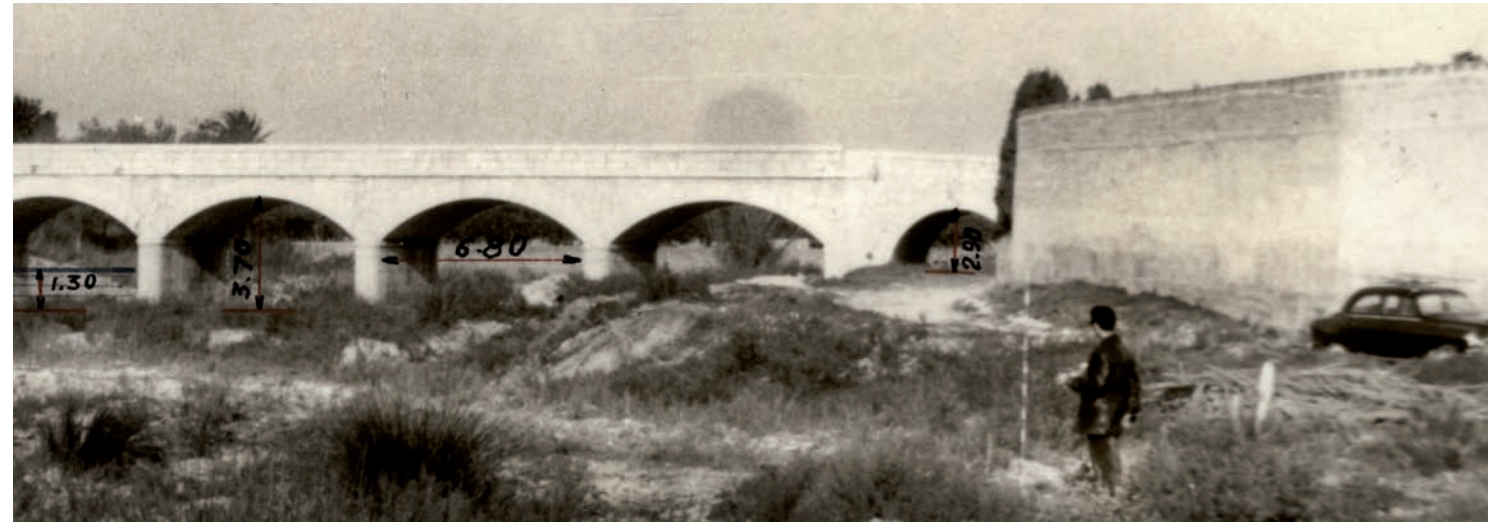
Puente sobre el río Gallinera. 1960? Carretera de Pego a Oliva, aguas arriba de la zona de inundación
