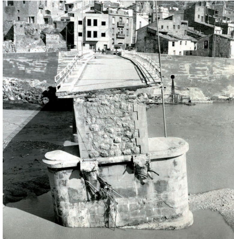
Puente de Ribesalbes (Castellón). 1967 Daños ocasionados por la crecida del 23 de octubre
